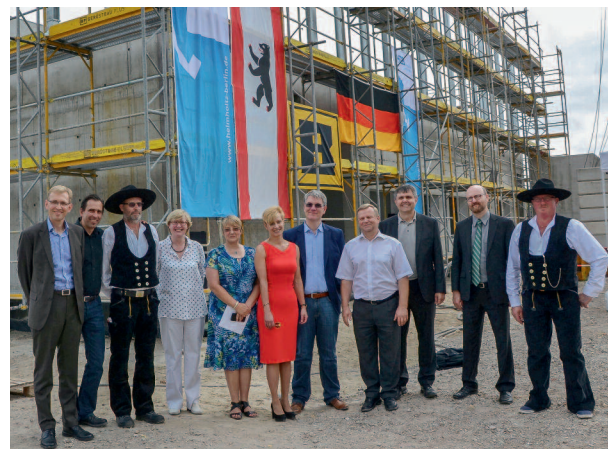
Fröhliche Gesichter beim Richtfest der neuen Beschleunigerhalle, das bereits zehn Monate nach Beginn der Arbeiten am 27. Juli 2016 gefeiert werden konnte.
